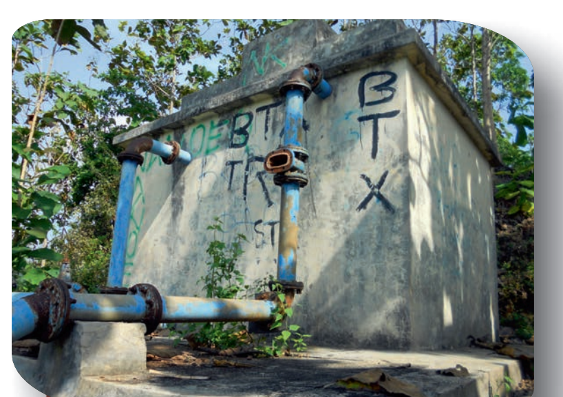
Tank zur Druckreduzierung
